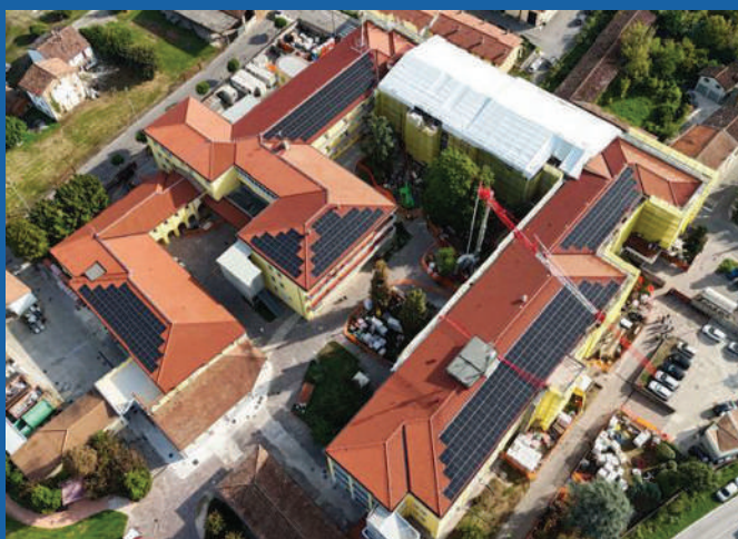
Rimozione totale dell'amianto, posa della nuova copertura ed installazione dell'impianto fotovoltaico per un totale di 199 kWp.
